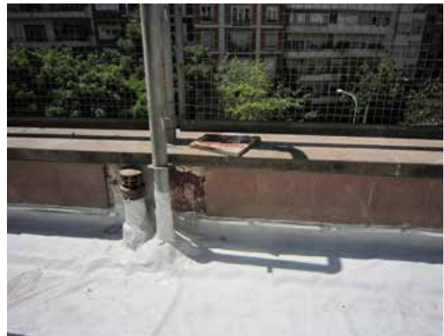
Foto 10. Detalle de borde exterior con babeta perimetral impermeable. (Foto M J Leveratto)
